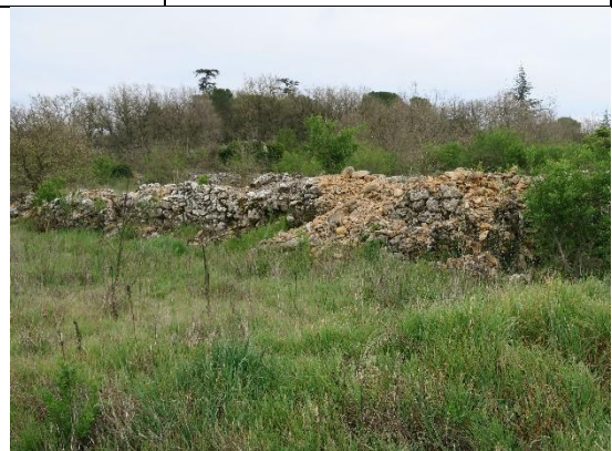
Dégradation des murets
